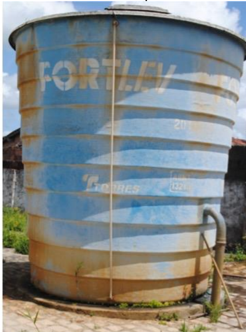
FIGURA 21 – Reservatório para bairro do Iraque.
